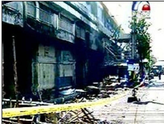
Gambar 6 Pasar Tambahrejo setelah Terbakar 11
